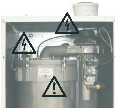
Pildil: süütrafo, kõrgepinge-süüteelektrood, soojusvaheti. Ohtlik elektripinge. Kuumade seadmeosadega kaasneb põletusohu.
